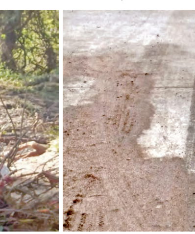
నారాయణఖేడ్లో గుంతలమయంగా ఉన్న రోడ్డు
